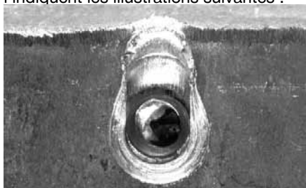
Déformation plastique de l'acier de base
